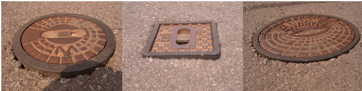
Typisches Erscheinungsbild: „herausgewachsene“ starre Straßenkappen in Asphaltstraßen.
